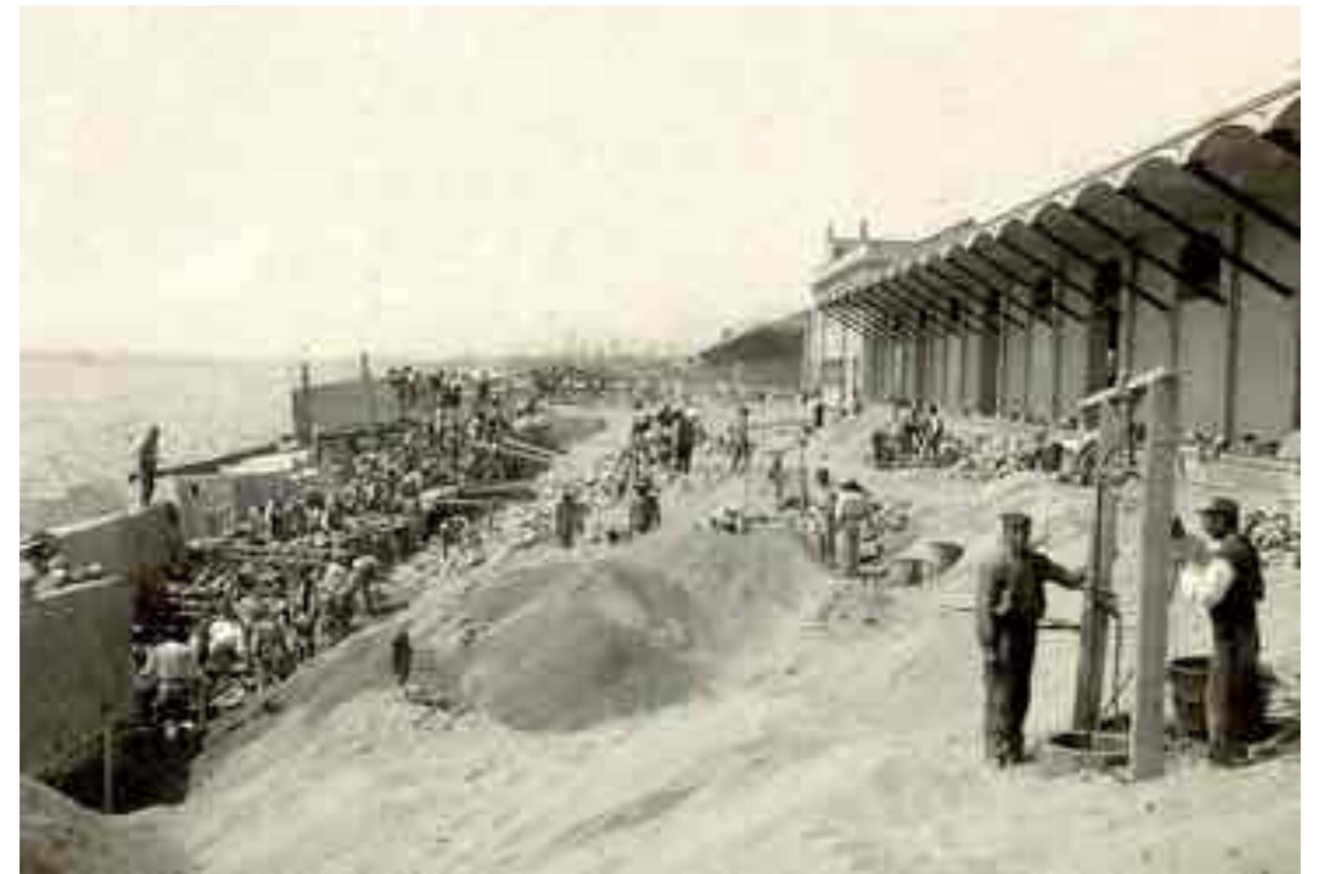
Obres que es van fer el 1907 per reforçar l'estació del Bogatell ❷ i evitar els embats del mar.
